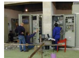
Системи за автоматизација, каблирање и шемирање
